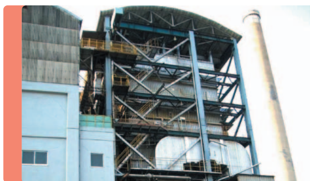
第2発電所廃材チップ混焼実証設備
