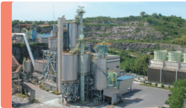
石炭／木材チップ混焼発電設備
