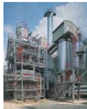
流動床式廃棄物燃焼設備(UMF)
