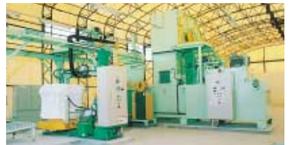
廃プラ圧縮梱包プラント
