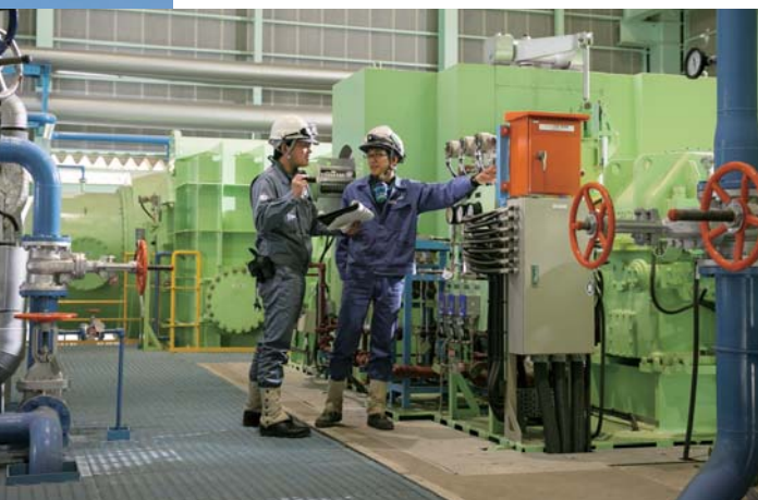
写真左：排熱発電設備・仮焼炉に新設された「PHボイラ」 写真右：排熱発電設備・タービン、発電機などを格納「タービン建屋」
