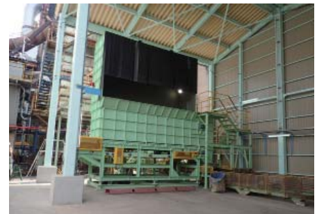
廃プラスチック破砕品ホッパー、抜出設備(苅田セメント工場)
