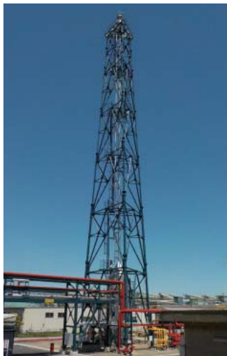
フレアスタック(千葉石油化学工場)
