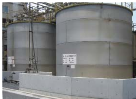
防液堤 (宇部ケミカル工場)
