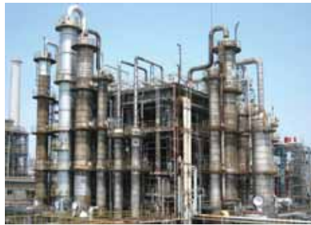
蒸留塔設備 (宇部ケミカル工場)
