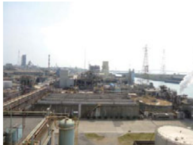
排水処理設備 (宇部ケミカル工場)
