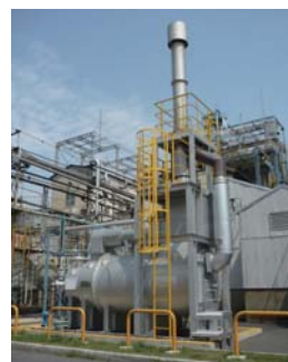
直燃式脱臭装置(宇部ケミカル工場)
