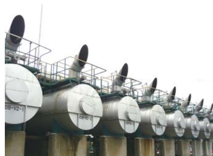
脱臭設備(千葉石油化学工場)
