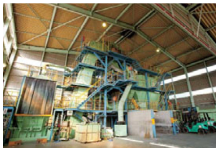
廃プラ類処理設備(宇部セメント工場)
