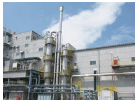
宇部ケミカル工場・ポリイミド製造施設 「水洗塔と吸収塔」
