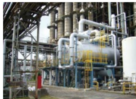
宇部ケミカル工場「シクロヘキサン回収設備」
