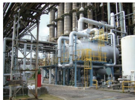
シクロヘキサン回収設備
