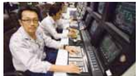
全プラントを集中管理するコントロールセンター
