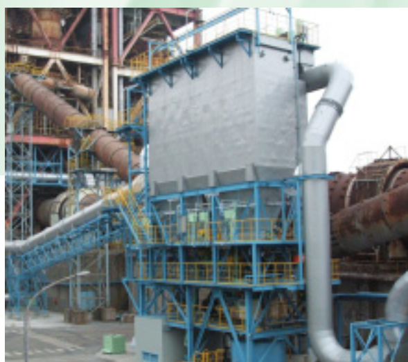
高塩素バイパス設備
