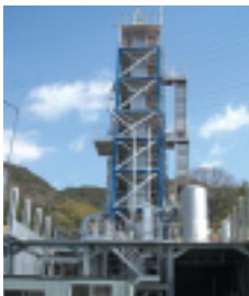
バイオマス・ガス化設備
