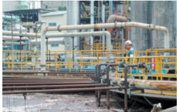
宇部ケミカル工場における排水処理設備
