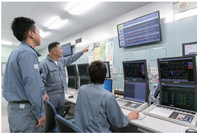
プラントを集中監視する計器室。中央の65インチ大型モニターは通常はプラントの稼働状況が示されていますが、将来の異常を予測すると自動的に画面が切り替わり、この先いつ、どのような異常が想定されるかが表示されます。運転員はそれを確認し事故を未然に防ぐよう迅速に対処します。
