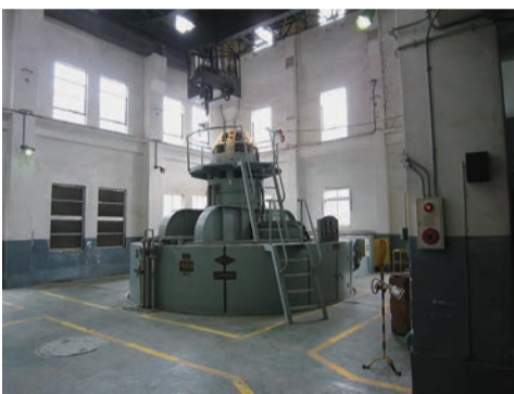
厚東川水力発電所建屋内に設置された昭和25年製の発電機。宇部興産の卓越した技能者による丁寧な整備で60年を超えて現役で活躍しています。
