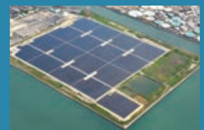
宇部市に建設したメガソーラー発電所（2014年7月営業運転開始）
