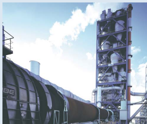
宇部セメント工場のNSPキルン
