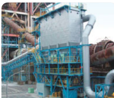
高塩素バイパス設備
